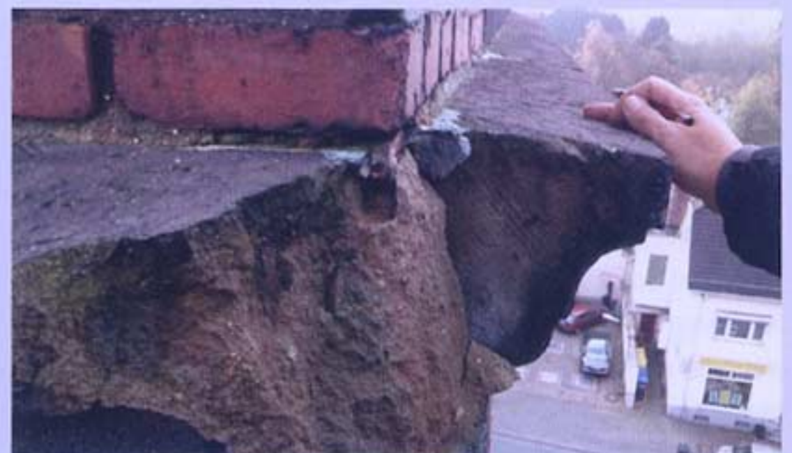
Gesimsabsprengung am Kirchturm: Folge von Ankerkorrosion
