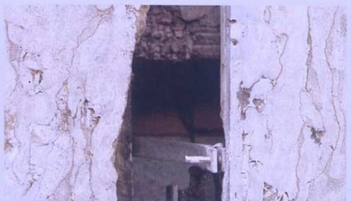
Unzureichend: Diese Verankerung ist nur an Stahldraht geschweißt
