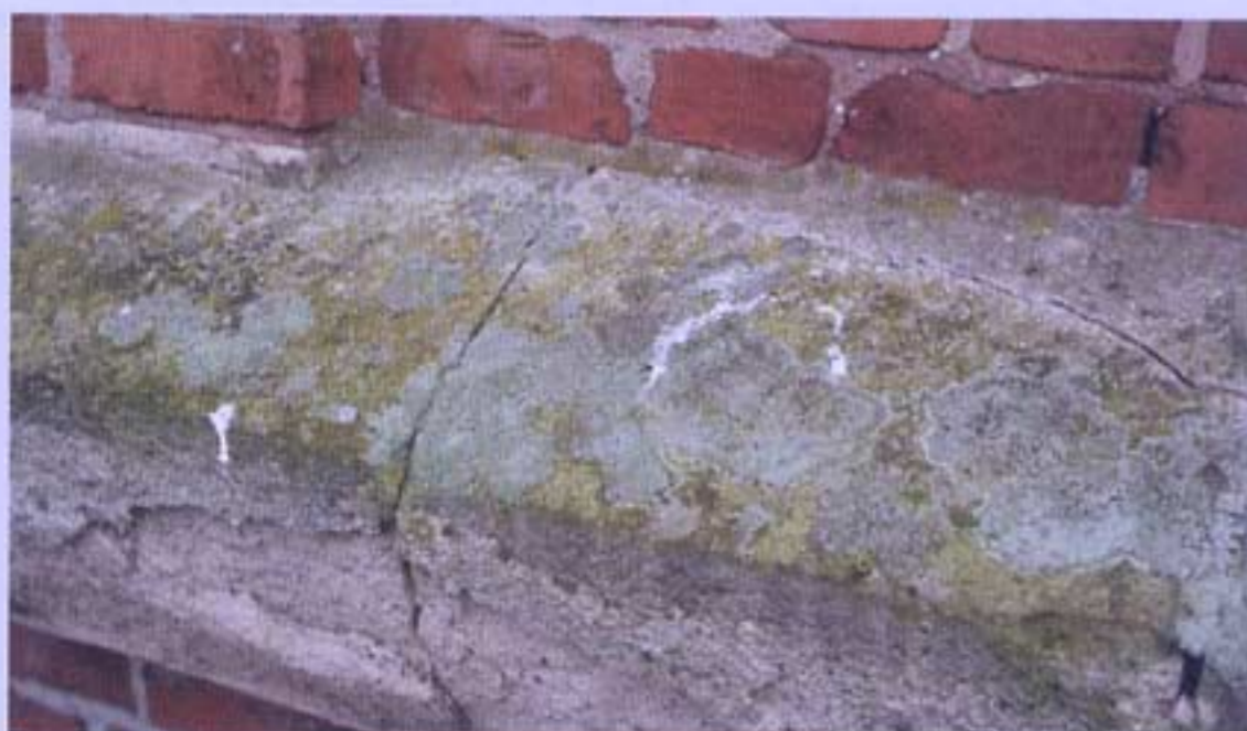
Nicht mehr standsicher: Absturzgefährdete Steinanteile sind zu fixieren
